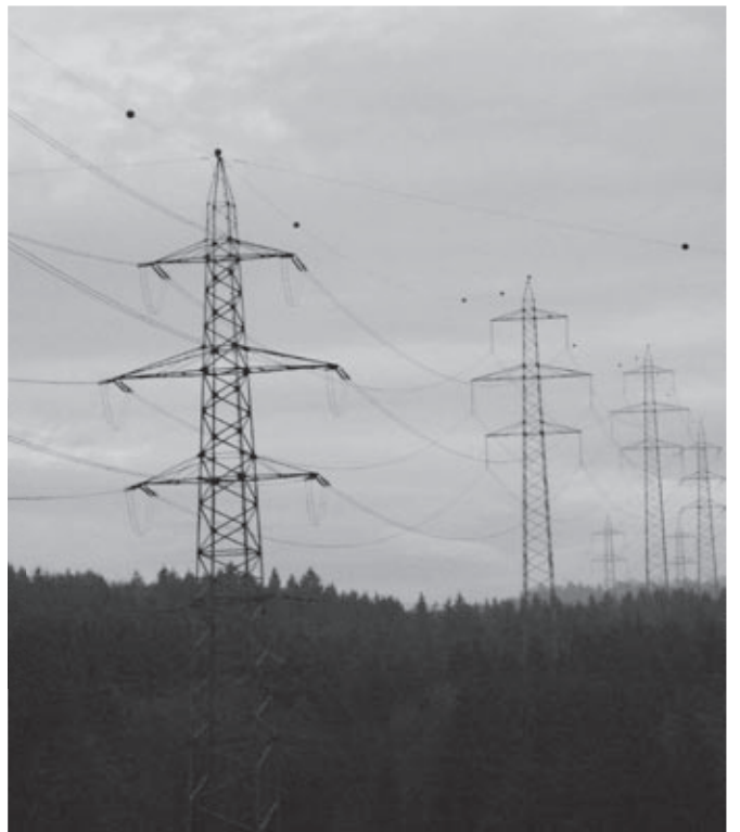
Hochspannungsleitung Gösigen-Mettlen bei Safenwil (AG): Die 100 Meter hohen Masten ragen wie Riesen aus dem Wald hervor.
