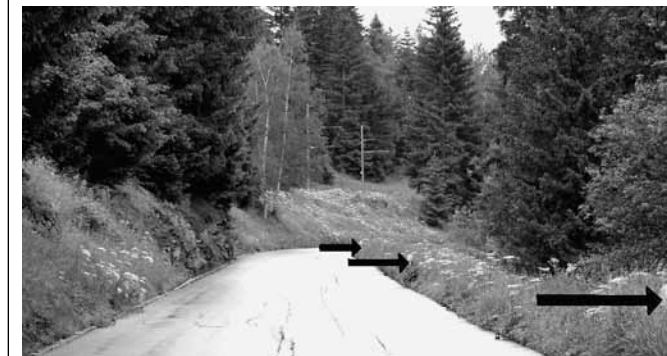
Kantonsstrasse zwischen Fürgangen und Niederwald am 15. Juni: Die Seitenlinie fehlt und der Strassenrand sowie die Pfosten sind fast ganz vom Gras überdeckt (siehe Pfeile), so dass der Lichtreflex nur noch gering ist.
