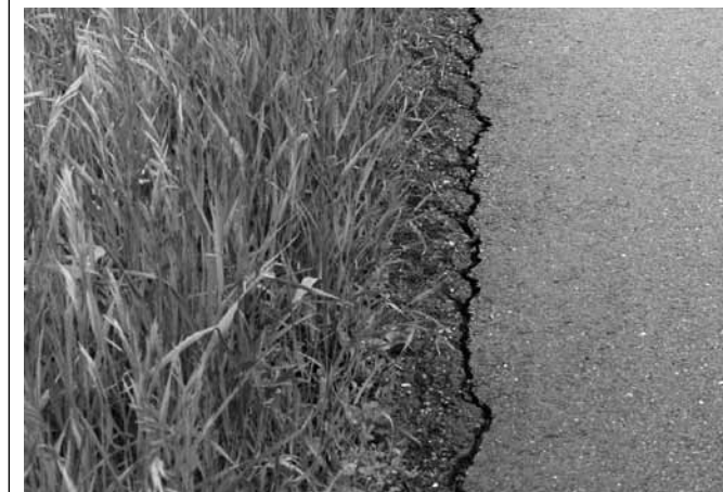
Kantonsstrasse zwischen Reckingen und Münster:
